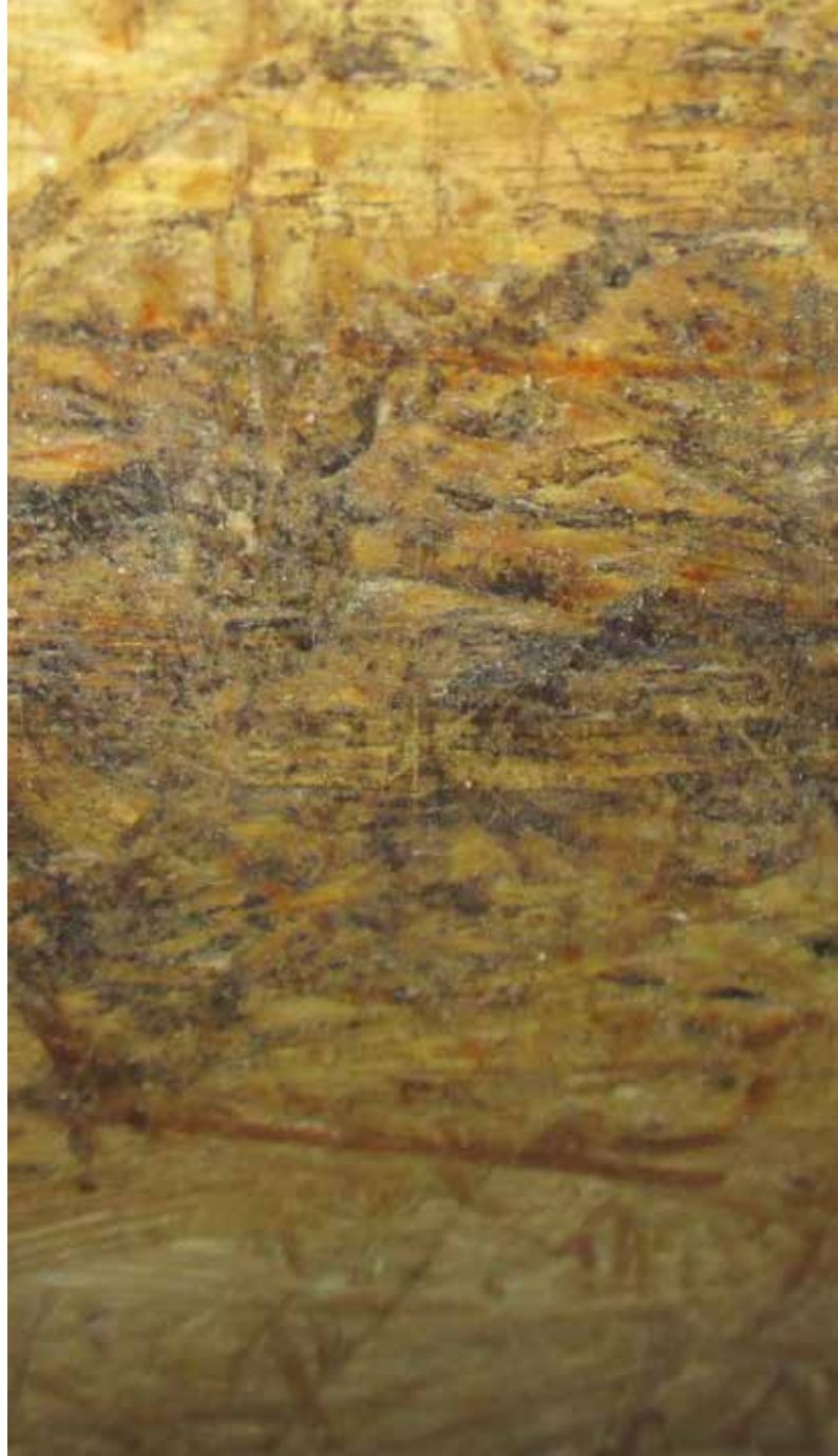
Abb. 2b – Reaktion von Baustoffen auf Feuchte (Nahaufnahme): Eingesetzte Baustoffe reagieren auf Baufeuchte mit Quellen, Änderung der Festigkeitswerte und ggf. Schimmelbildung oder Stockflecken auf der Oberfläche. Verfärbungen können innerhalb kurzer Zeit auftreten.
