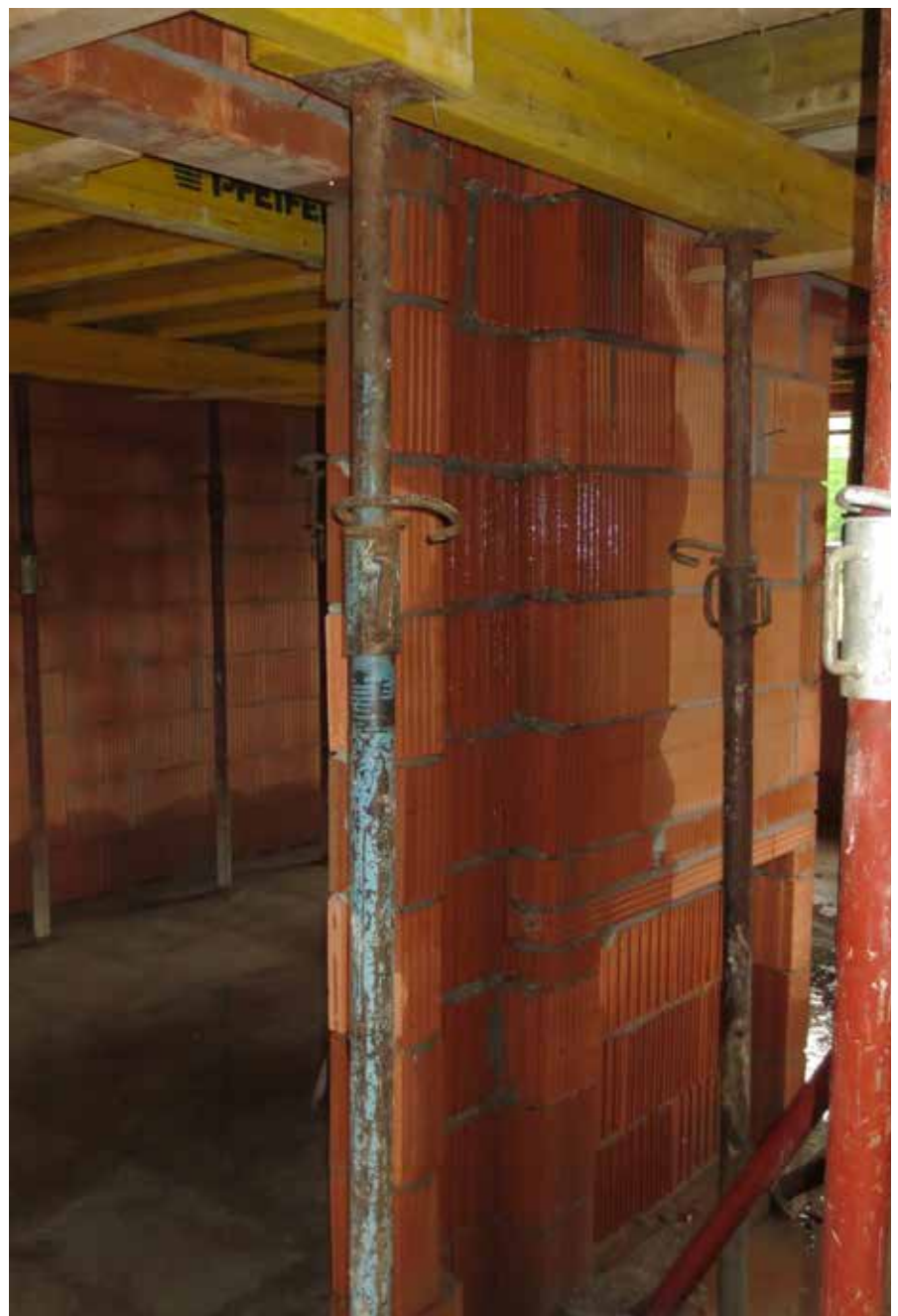
Abb. 3: Tagwasser kann in Mauerwerk zu hohen Feuchtegehalten führen. Wird diese Durchfeuchtung nicht gewissenhaft getrocknet ist Neubauschimmel kaum vermeidbar. Folgegewerke sollten ggf. Bedenken anmelden.
