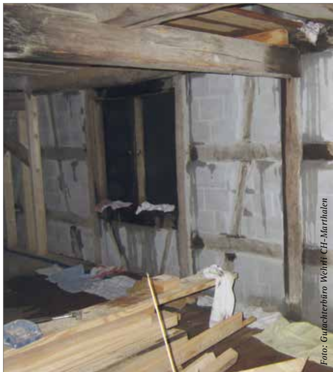
Schlagregen auf der Innenseite einer Riegelwand.
