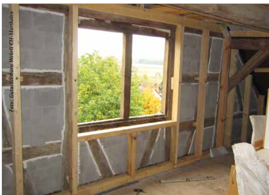
Innenputz bei Riegelwand, nachgebessert: Die Anschlussfugen zwischen Ausfachung und Riegel wurden sorgfältig nachgebessert, damit der Schlagregen nicht mehr so leicht eindringen kann
