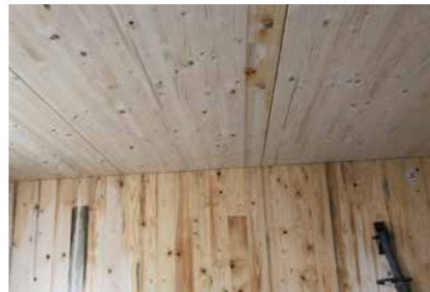
Unschöne Wasserflecken an einer Brettspertholzdecke
